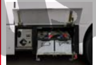
Le due batterie sono poste sul lato sinistro.
